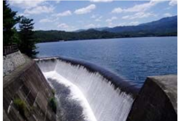
写真2：洪水吐 (香川県HPより)
