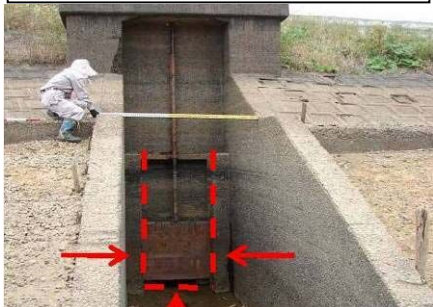
写真 33：ゲート周りの漏水
