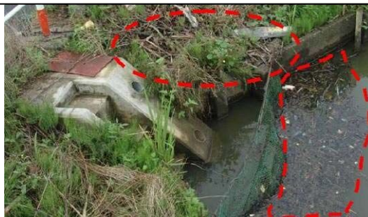
写真 34：取水部周辺の土砂やゴミの堆積
