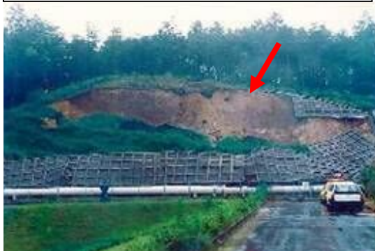
写真 37：堤体付近の法面(崩壊後)
