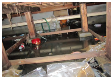
水や泥がたまってしまった床下の様子
