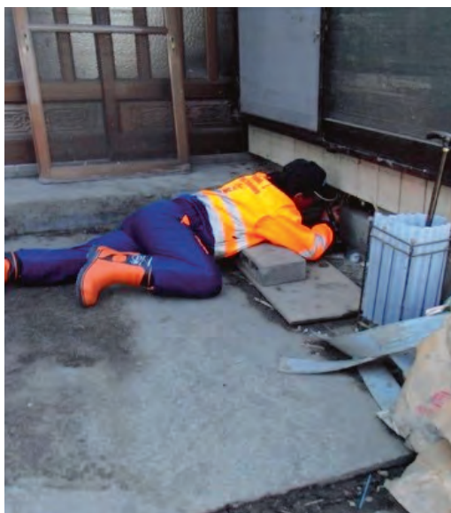
通風口から床下の泥を確認する
