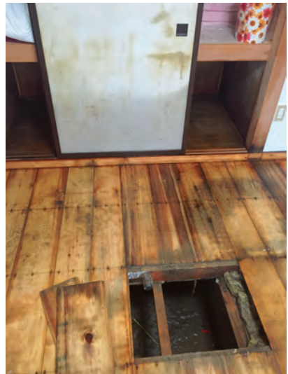
室内の被害状況も撮っておく
