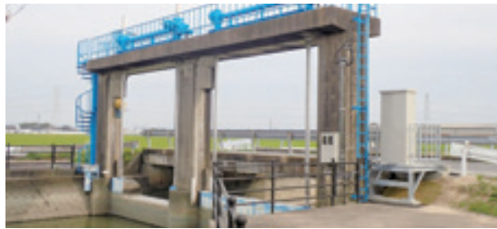
電動化された水門
