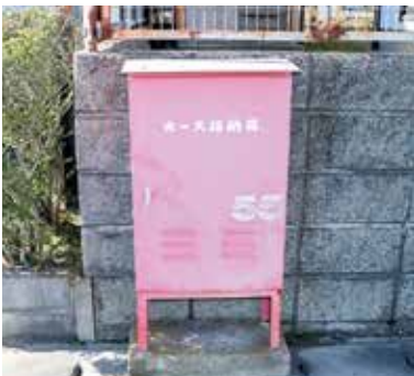
消防BOX（ホース格納箱）
