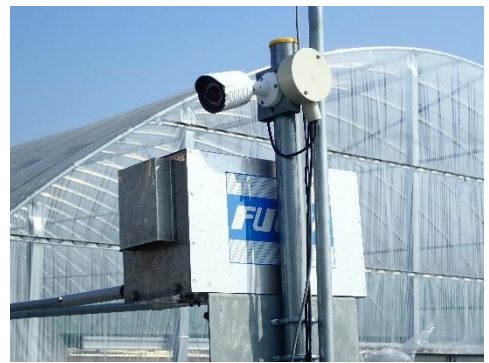
防犯カメラの設置
