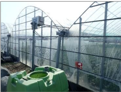
防犯カメラの設置
