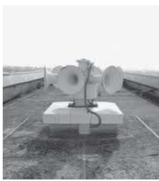
役場屋上サイレン
