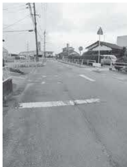
消えかかった道路標示（横断歩道）
