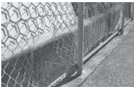
老朽化したネットフェンス（下坊所）
