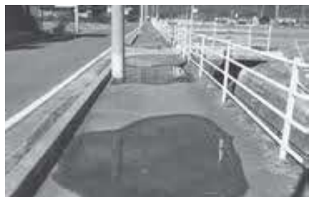
歩道の水たまり（上坊所）
