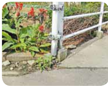
▶根本から折れ、応急処置された標識
