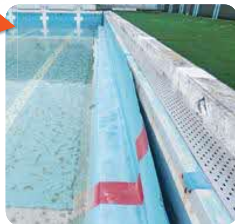
改修を要する小学校の大プール
