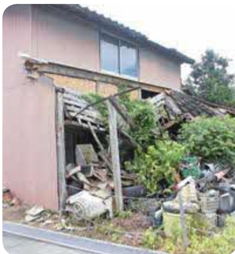
町内の空き家
