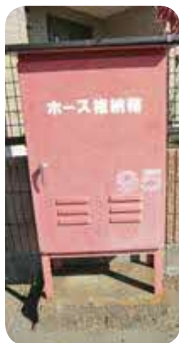
消火栓ボックス
