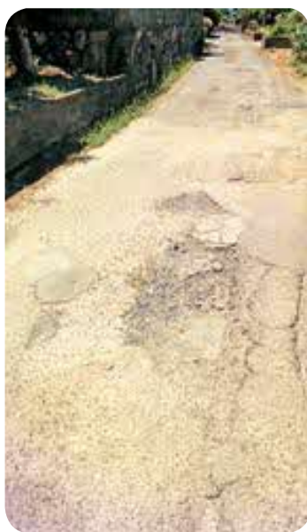
下坊所東西線の荒れた路面
