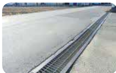
排水不良の側溝
