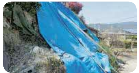
危険な急傾斜地
