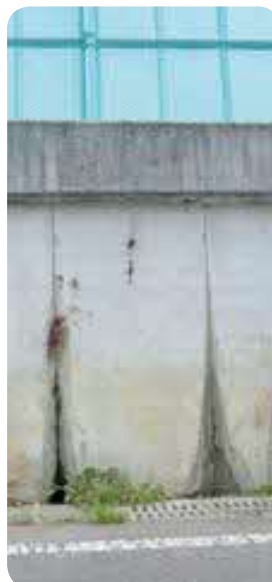
小学校プールの水漏れ箇所
